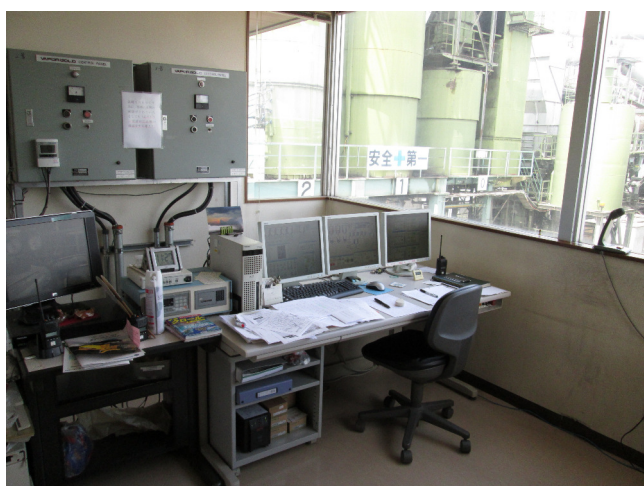
アスファルトプラント操作室
