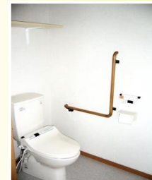
居室内トイレ
