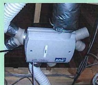
装置は天井裏に設置します。
