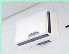
室内側給気口
