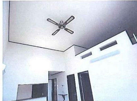
2F居間部 シーリングファン
