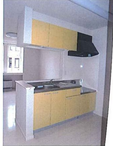
流し台・レンジフード・吊り戸棚
