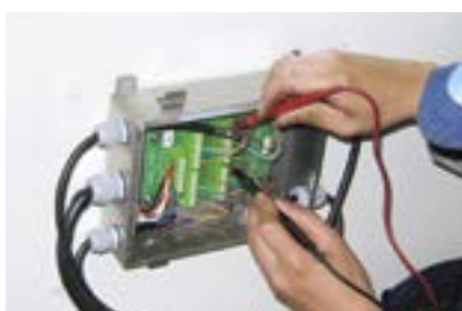
ロードセル定期点検
