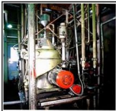
廃オイル⇒再生重油 30m 3 /日(10時間稼働)
