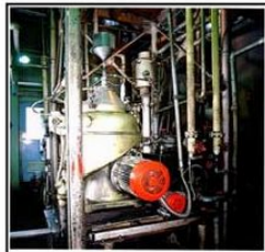
廃オイル⇒再生重油 30m 3 /日(10時間稼働)
