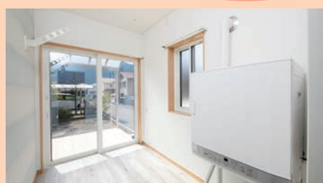
サンルームには物干しと乾燥機の「乾太くん」を。雨や花粉を気にせず洗濯物が干せる。洗面脱衣室とも一直線の同線で家事をラクに。
