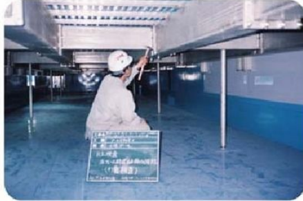
床フレーム点検
