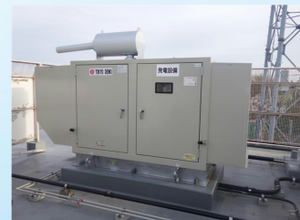
●発電機・非常用発電機
