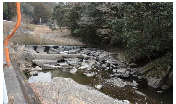
伊久美川洪水時はこの落差工で魚類の行き来が寸断されてしまうことから、早期の改修を目指します。
