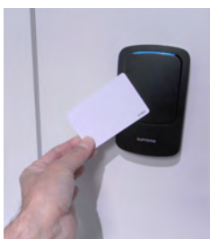
▲セキュリティカード認証システム
